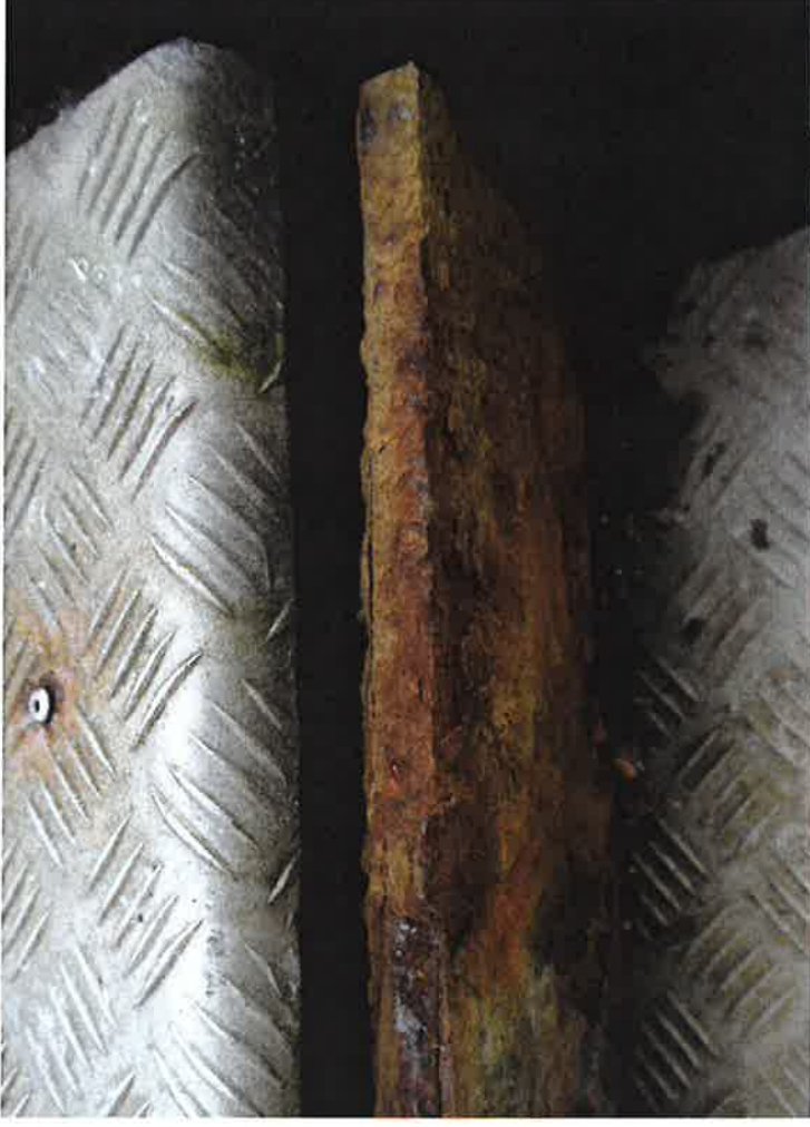
LØSE TRINN AV STØPEJERN
